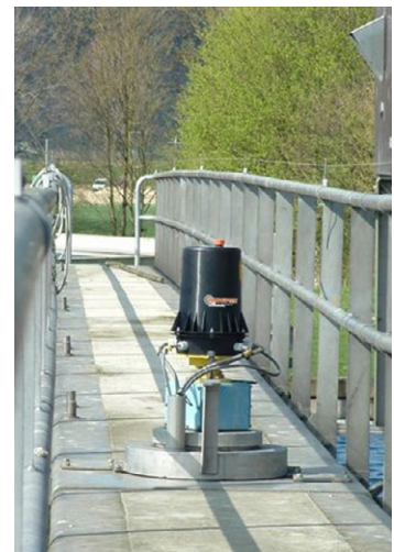
Schleifringkörper in Rundräumer (Kläranwerk)
